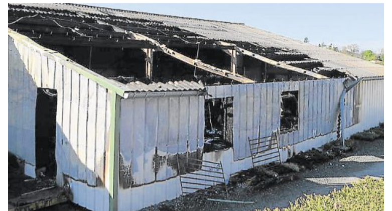
L'espace de 500 m 2 a été gravement endommagé par l'incendie.
